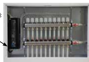
Zonenmodul im Fußbodenverteilerkasten
